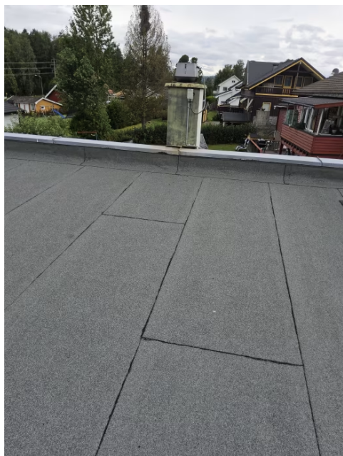
Bilde viser manglende takstige.
