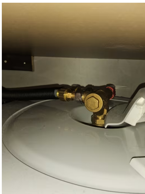
Bilde viser plastrør rett på varmtvannsbereder.
