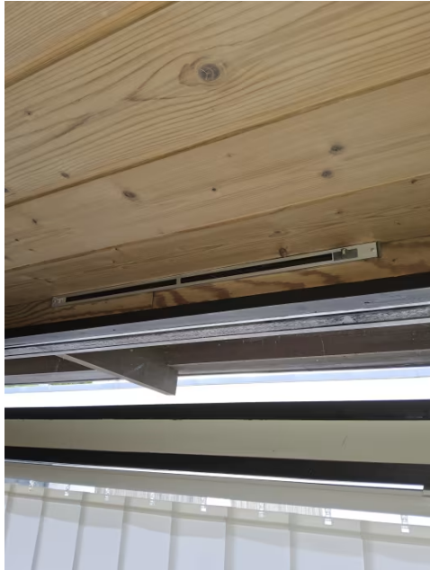
Bilde viser spalteventil i yttervegg.
