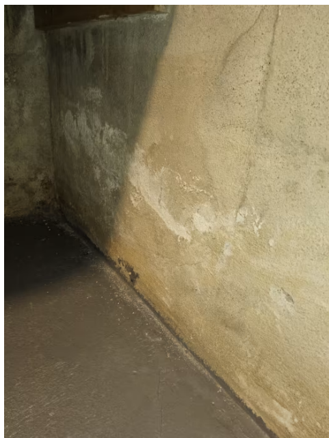
Bilde viser saltutslag på yttervegg.
