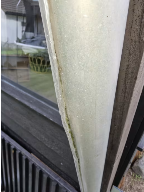
Bilde viser buling i nedløpsrør.
