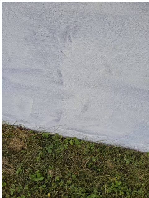
Bilde viser riss i grunnmur.
