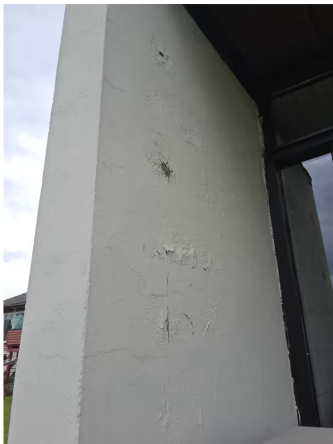
Bilde viser avflassing på murfasadene.
