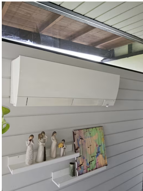
Bilde viser varmepumpe.
