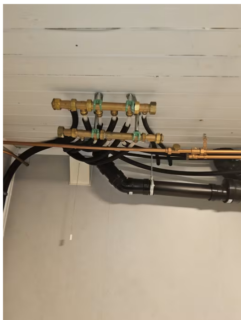
Bilde viser åpen rørfordeling.
