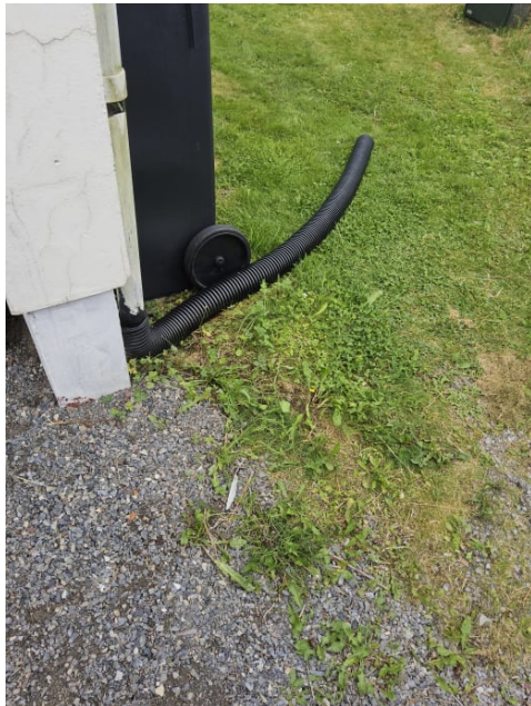
Bilde viser taknedløp avsluttet over bakken.
