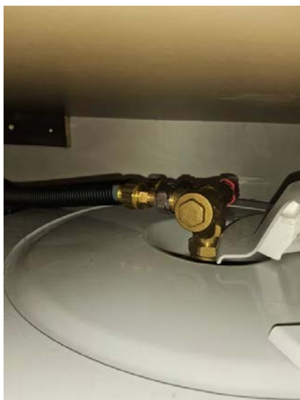
Bilde viser plastrør rett på varmtvannsbereder.
