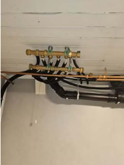
Bilde viser åpen rørfordeling.
