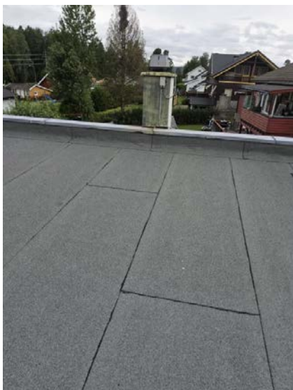
Bilde viser manglende takstige.
