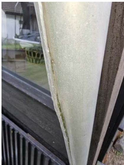
Bilde viser buling i nedløpsrør.
