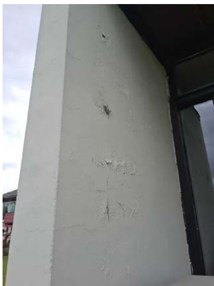
Bilde viser avflassing på murfasadene.
