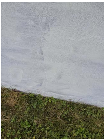
Bilde viser riss i grunnmur.
