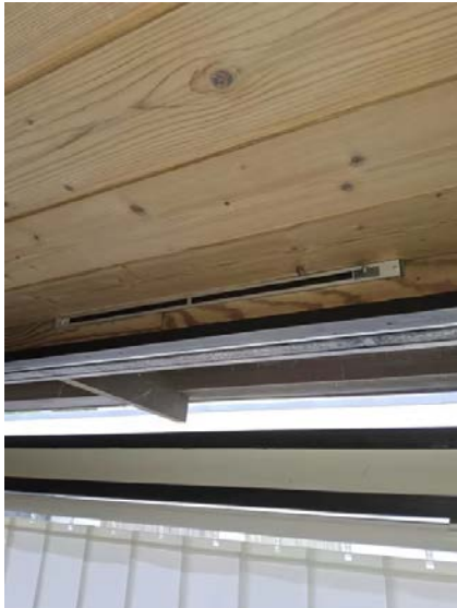
Bilde viser spalteventil i yttervegg.
