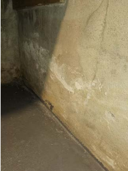
Bilde viser saltutslag på yttervegg.
