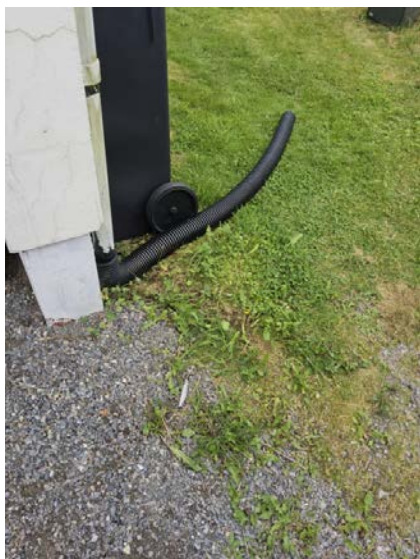
Bilde viser taknedløp avsluttet over bakken.
