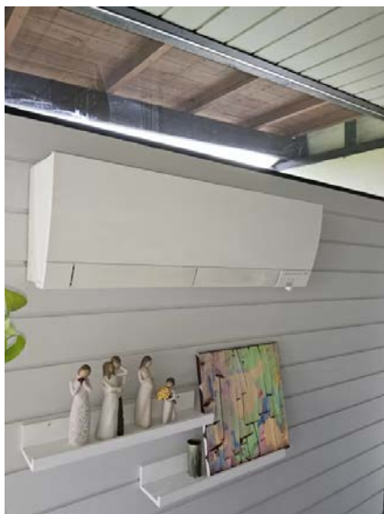
Bilde viser varmepumpe.
