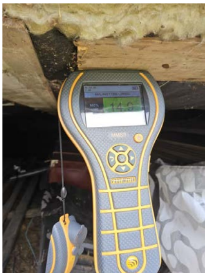
Bilde viser fuktmåling i krypkjeller.
