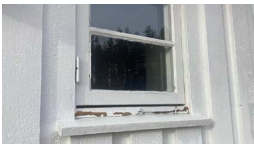
Eksempel på slitasje.
