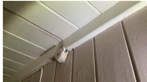
Eksempel på forhold som vil medføre avvik ved en eventuell el-kontroll.
