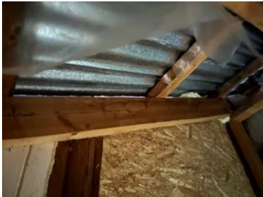
Utetthet mellom taktekkning på tilbygget del og vegg på opprinnelig del.
