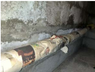
Motfall på avløpsrør i kjeller.
