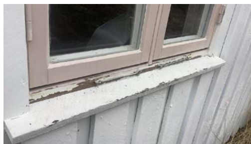
Eksempel på slitasje.
