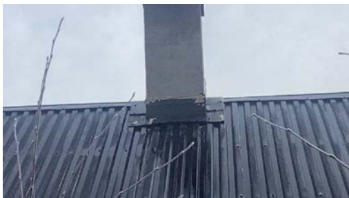
Det overgangsbeslag på pipe. Dette er sårbare løsninger som bør følges med på.
