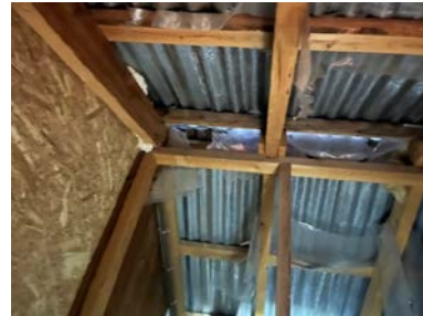
Det er utettheter i møne på tekking over tilbygget del. Dette gjelder også i enkelte plateskjøter.
