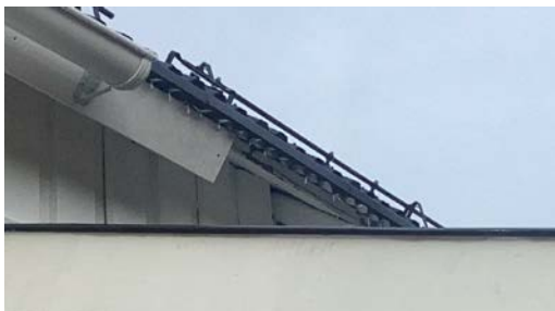
Det er noen steder slitasje på takfot.
