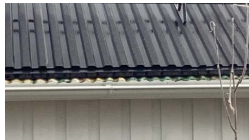
Det er ikke montert takfotbeslag.
