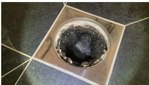
Sluk av plast. Det kan ved inspeksjon ikke konstateres bruk av membran.
