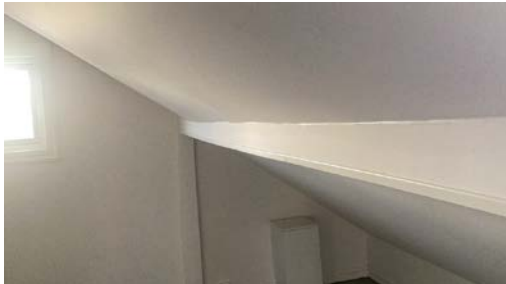
Ujevne overganger mellom himlinger og dragere.
