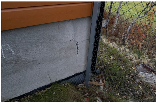
Eksempel på sprekk i grunnmuren
