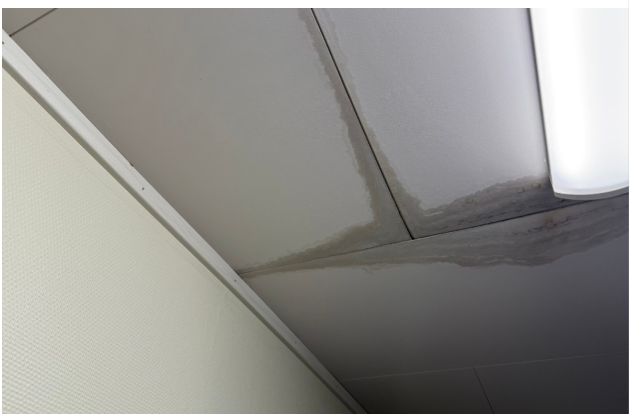
Fuktskade i himling på tavlerom
