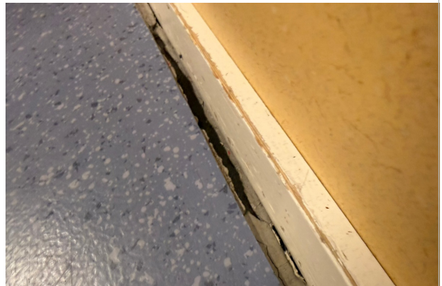
Sprekk mellom gulvet og veggen som har oppstått etter bygget var ferdigstilt.
