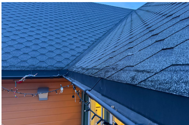
Spredt mosedannelse på taktekkingen
