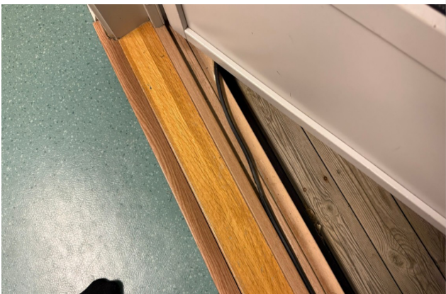
Eksempel på skade på dør, her løst pakning/tettelist
