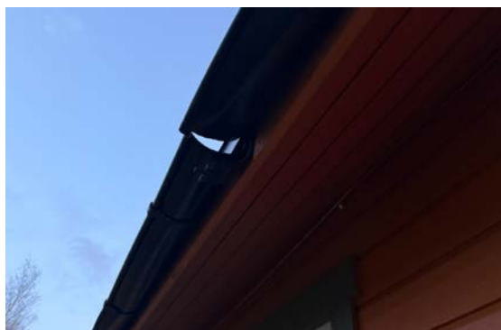
Eksempel på lekkasje/utetthet i takrenne
