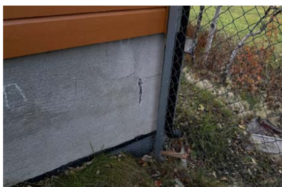
Eksempel på sprekk i grunnmuren
