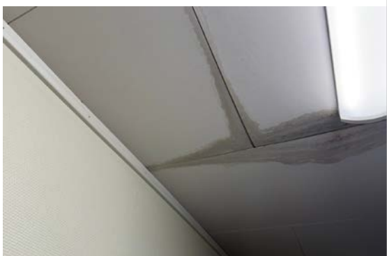
Fuktskade i himling på tavlerom
