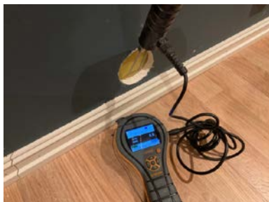
Hulltaking mot øst viser en vektprosent i bunnsvill på 8,8 vektprosent
