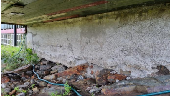
Sprekker i grunnmur mot sørøst.
