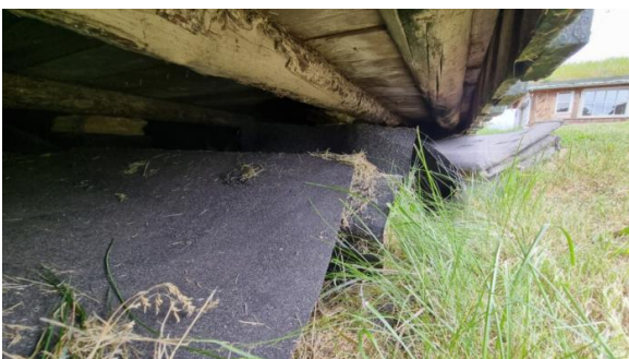
Meget begrenset inspeksjonsmulighet under hele fritidsboligen.
