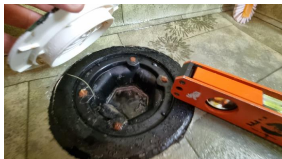
Kontroll av sluk. Belegget er ikke montert med klem under slukring.
