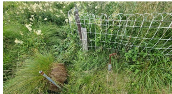
Stoppekran ved tilkoblingspunktet.
