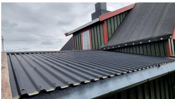
Platetak over entre/trappegang.
