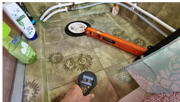
Fuktmåling i gulvet i dusjnisen, forhøyede fuktverdier ble registrert.
