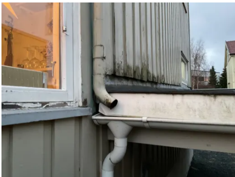
Råte i kledning.
