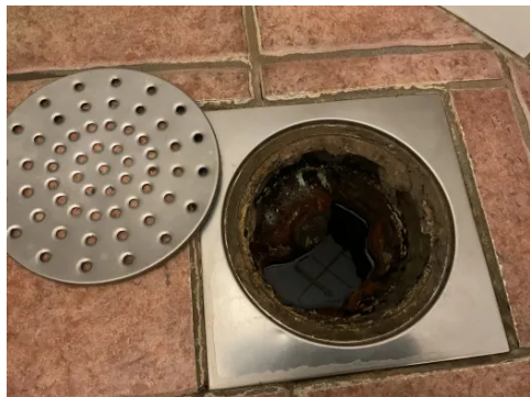
Eldre solisluk fra byggeår.
