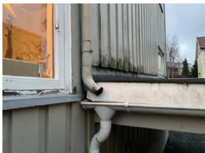
Råte i kledning.
