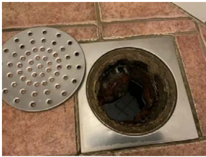
Eldre solisluk fra byggeår.
