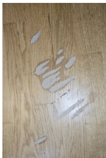
Skade i gulv som er fylt med sparkel.
