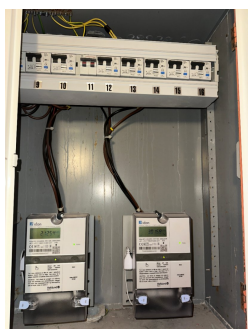
Sikringsskap med automatsikringer.
