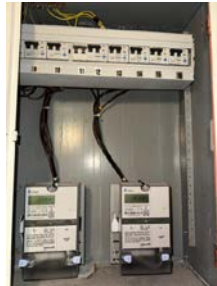
Sikringsskap med automatsikringer.
