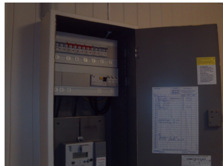
Sikringsskap med strømmåler
