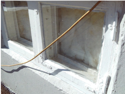
Eldre kjellervinduer fra byggeåret.
