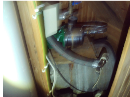
Eldre trykktank under trapp.
