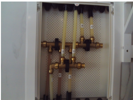
Fordelerskap på bad/vaskerom
