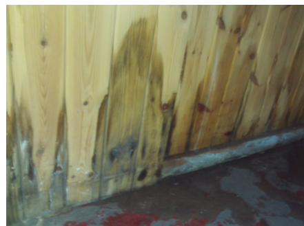
Noe oppsug av fuktighet i panel til skillevegger boder.
