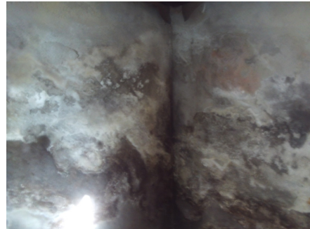
Eldre fuktmerker og salutslag.
