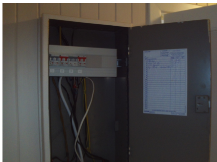
Sikringsskap uten strømmåler.
