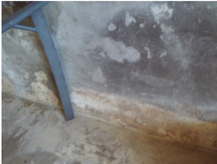
Fuktvandring i nedre del av grunnmur og støpte kjellergulv
