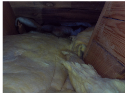
Ingen lufting av skråtak
