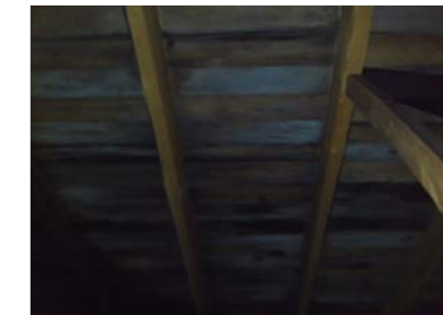
Noe misfarging på takbord.
