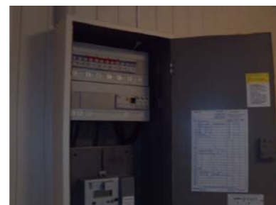
Sikringsskap med strømmåler
