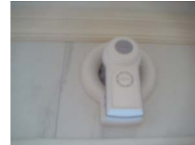
Fuktstyrt vifte i ytterveggen.
