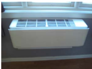
Varmepumpe på trimrom.
