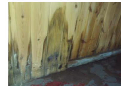
Noe oppsug av fuktighet i panel til skillevegger boder.
