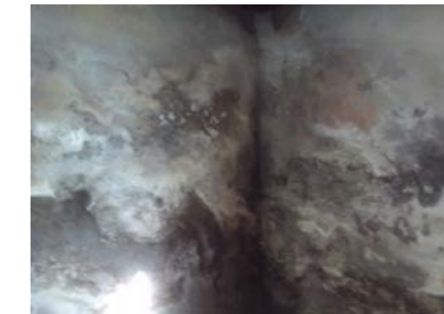
Eldre fuktmerker og salutslag.
