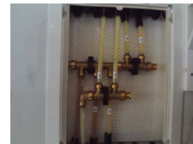
Fordelerskap på bad/vaskerom
