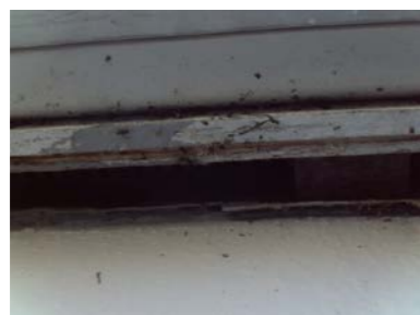
Lite/ingen tilgang på luft ved grunnmur på fasader som ikke er kledd på nytt
