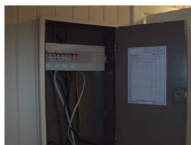
Sikringsskap uten strømmåler.
