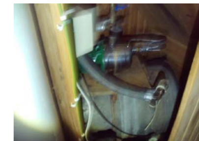
Eldre trykktank under trapp.
