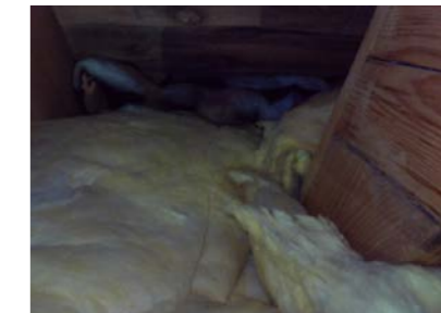
Ingen lufting av skråtak
