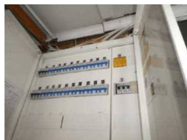
Sikringer i sikringsskap
