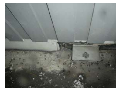
Manglende topplister og vindu til kjeller under gulvnivå på carport
