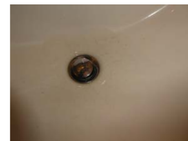
Overflatesprekker i servant
