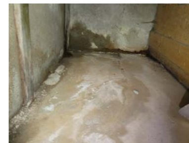
Fukt og setningssprekker i kjellergulv
