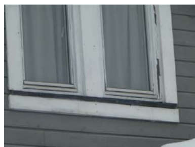
Slitasje på vinduer i loftsetasje
