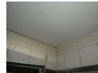
Glippe mellom taklist og himling
