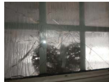
Sprekt glass i dør til bod.
