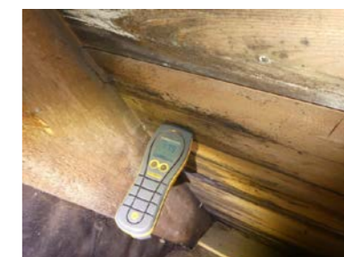
Fuktmåler i undertak der det ble påvist høye fuktverdier
