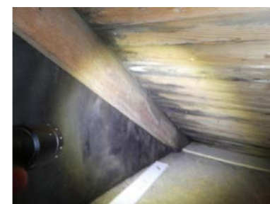
Fuktskjolder i undertak
