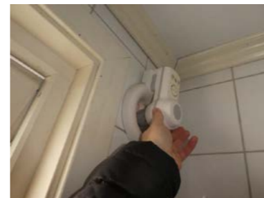
Ventil med behov for ytterligere innfesting.
