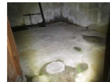
Fukt og setningssprekker i kjellergulv
