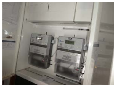
2 strømmålere i sikringsskap
