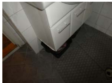
Svelling på innredning
