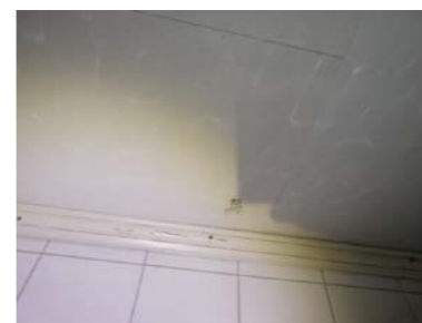
Lokal sopp i overflater av himling
