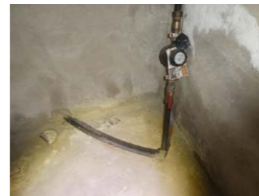
Vanninntak med stoppekran og vannmåler
