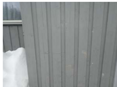
Skjøt av panelbord som medfører risiko for fuktopptrekk i skjøt. Anbefales skiftet ut med helt bord.
