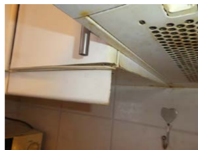
Skade på skapfront
