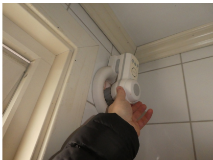
Ventil med behov for ytterligere innfesting.
