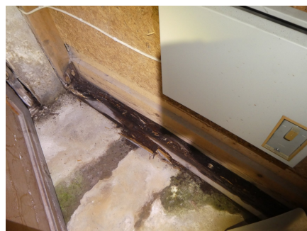
Råte i vegger mot kjellergulv
