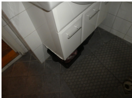
Svelling på innredning
