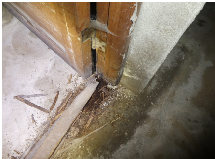
Råte i karm på dør i kjeller
