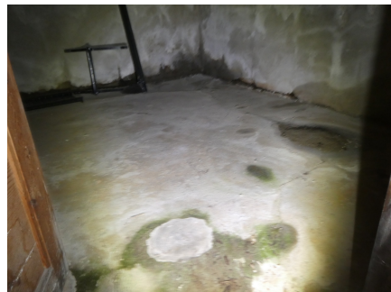
Fukt og setningssprekker i kjellergulv
