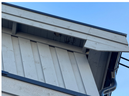
Fuktskade i undertak på takutstikk
