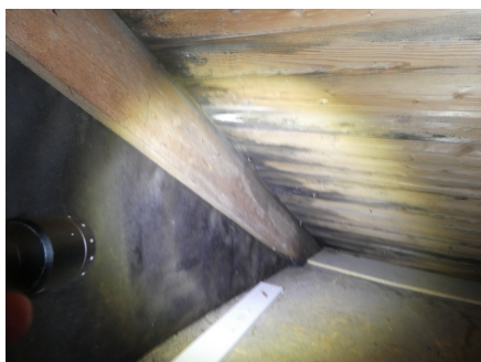
Fuktskjolder i undertak
