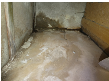
Fukt og setningssprekker i kjellergulv
