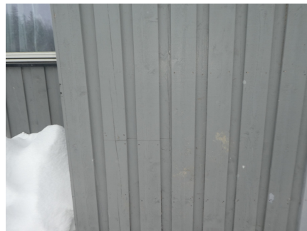
Skjøt av panelbord som medfører risiko for fuktopptrekk i skjøt. Anbefales skiftet ut med helt bord.
