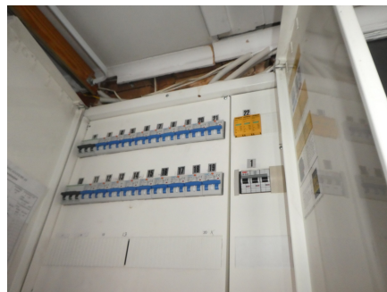
Sikringer i sikringskap
