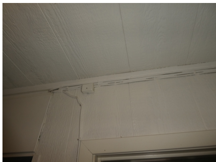
Estetisk ufagmessig ledningsopplegg
