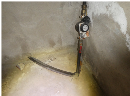
Vanninntak med stoppekran og vannmåler
