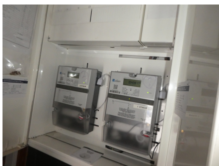
2 strømmålere i sikringsskap
