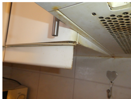
Skade på skapfront
