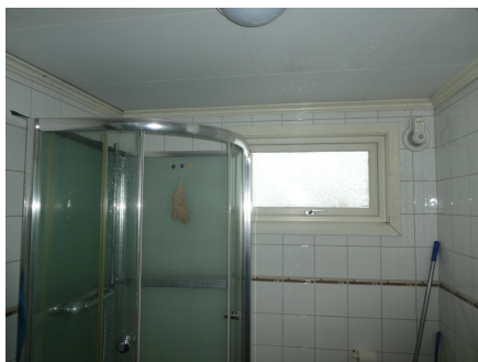
Vindu plassert i våtzone
