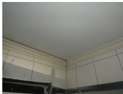
Glippe mellom taklist og himling
