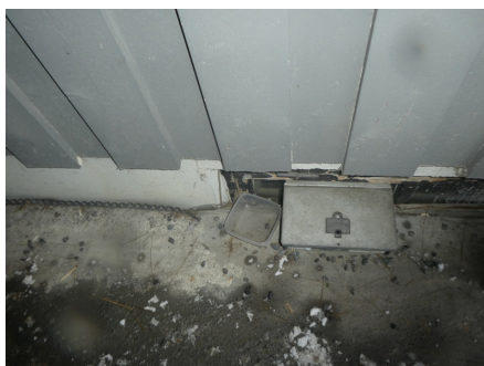
Manglende topplist og vindu til kjeller under gulvnivå på carport
