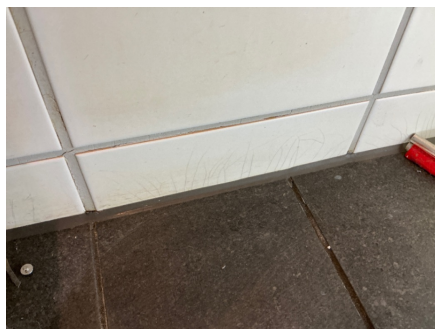
Krakkeleringer i fliser.
