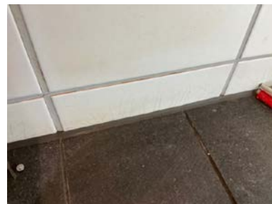
Krakkeleringer i fliser.
