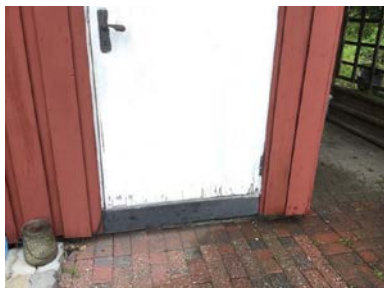
Ytterdør til utvendig bod i dårlig stand.
