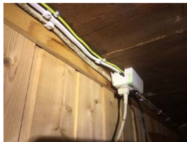
Dårlig håndverksmessig utførelse på deler av anlegget i kjeller.
