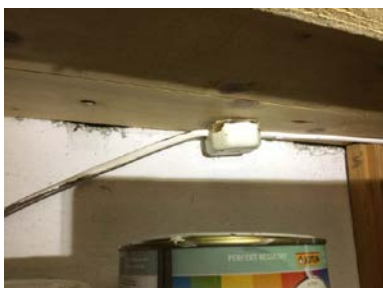
Løse ledninger registrert.
