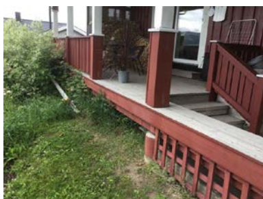
Deler av terrasse mangler rekkverk.
