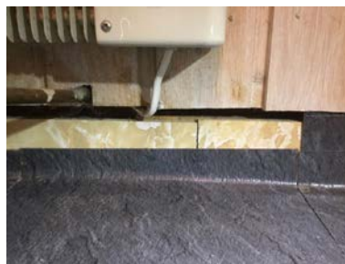
Åpninger i konstruksjon mellom gulv/vegg.
