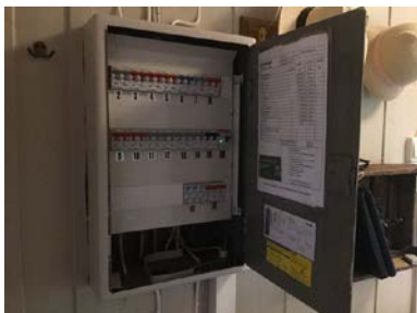
Sikringskapp plassert i gang 1. etasje.
