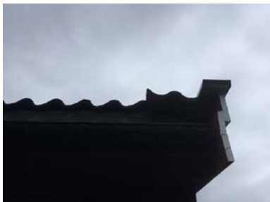
Løs takstein ved takfot.
