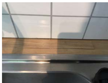
Fuktskade på benkeplate.
