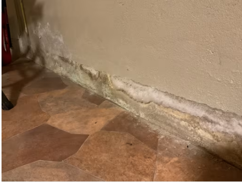
Salt/kalkutslag på vegger i kjeller.
