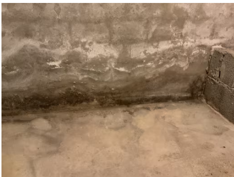
Salt/kalkutslag på vegger i kjeller.
