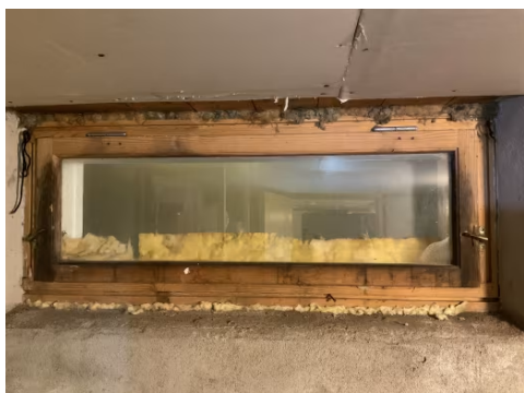
Vindu i kjeller med fuktskade.
