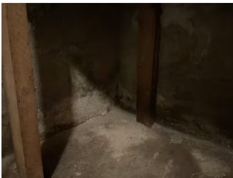
Salt/kalkutslag på vegger i kjeller.
