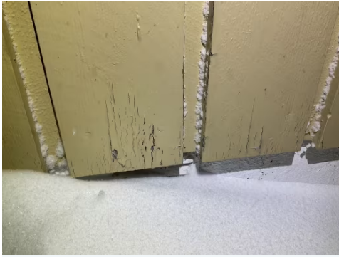
Sprekk i overflatebehandling.
