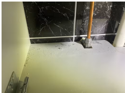
Gjennomføring i vegg.
