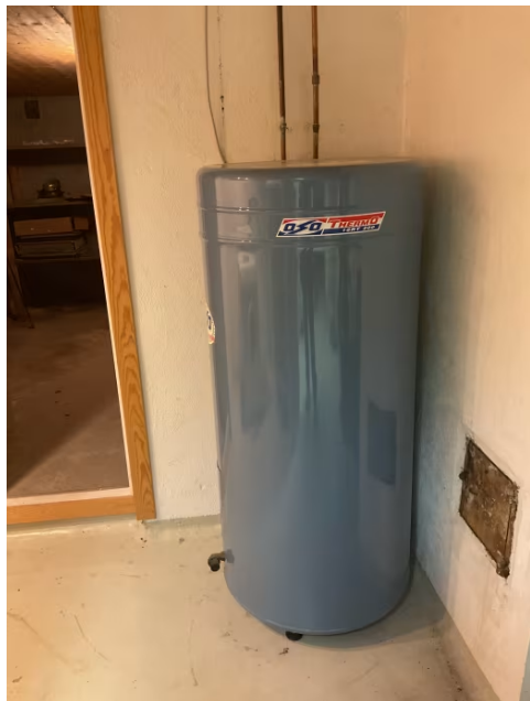
Bereder plassert i kjeller.
