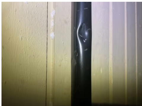
Bulk i nedløpsrør.
