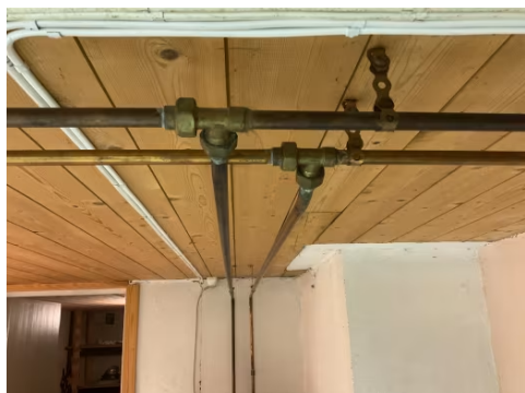
Vannrør i kjeller.
