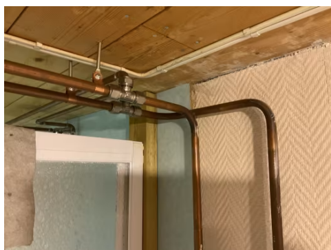
Vannrør i kjeller.
