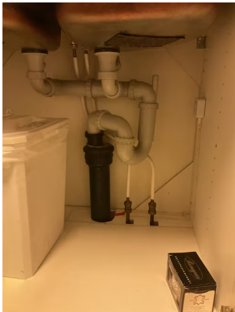
Avløpsrør i kjøkkenbenk.
