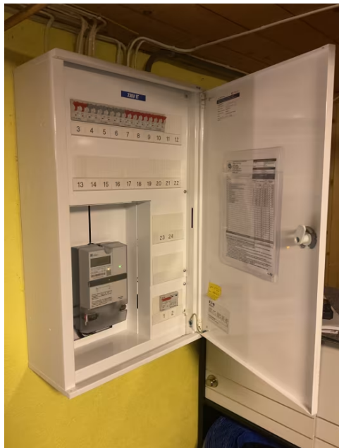
Sikringskap plassert i kjeller.
