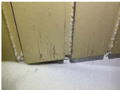
Sprekk i overflatebehandling.
