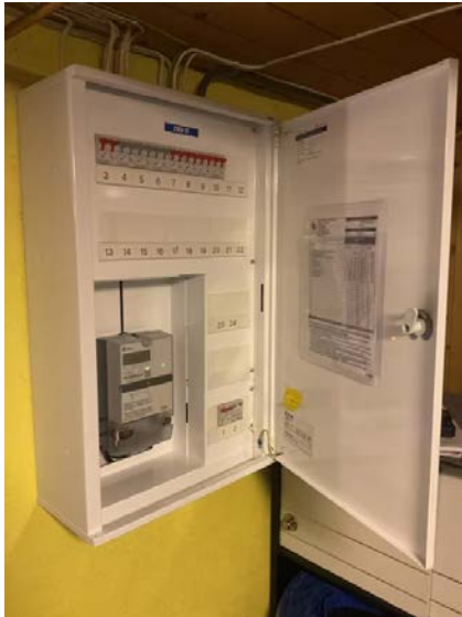
Sikringskap plassert i kjeller.
