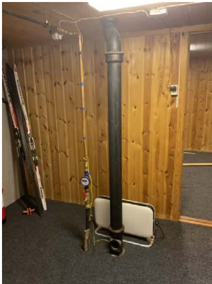
Avløpsrør i kjeller.
