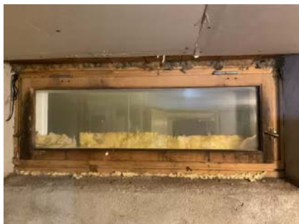
Vindu i kjeller med fuktskade.
