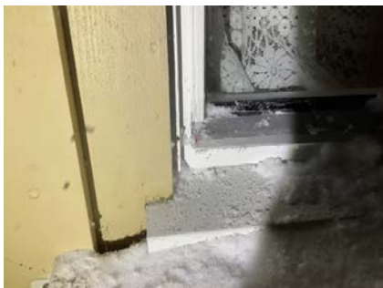
På noen av vinduene står utvendige listverk ned mot vannbrett og trekker opp vann.
