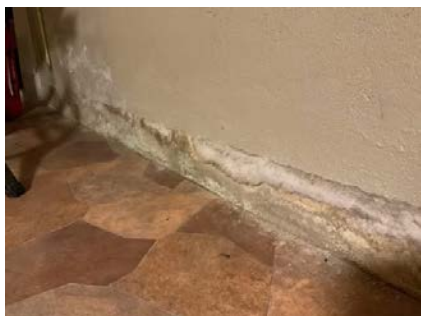
Salt/kalkutslag på vegger i kjeller.
