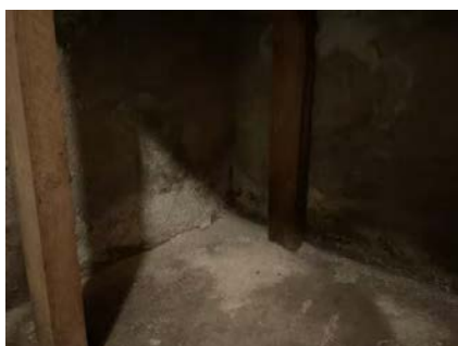
Salt/kalkutslag på vegger i kjeller.
