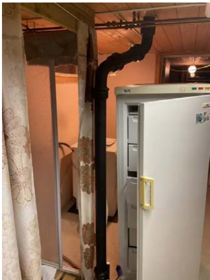
Avløpsrør i kjeller.
