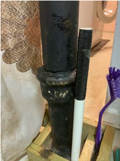
Avløpsrør i kjeller.
