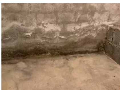
Salt/kalkutslag på vegger i kjeller.
