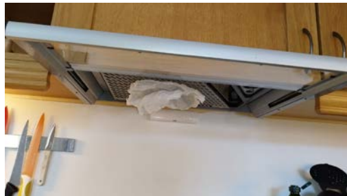
Test av avtrekket.
