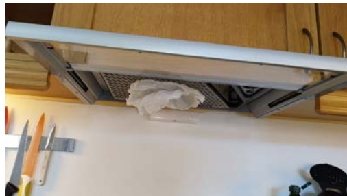
Test av avtrekket.
