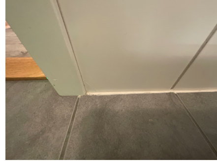
Liten sprekk i flis ved dør.
