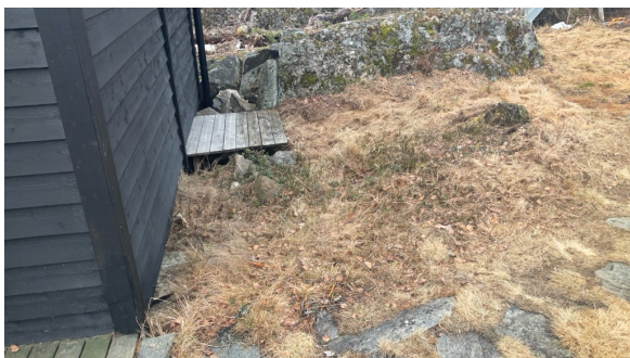
Lokalt fall mot grunnmur.
