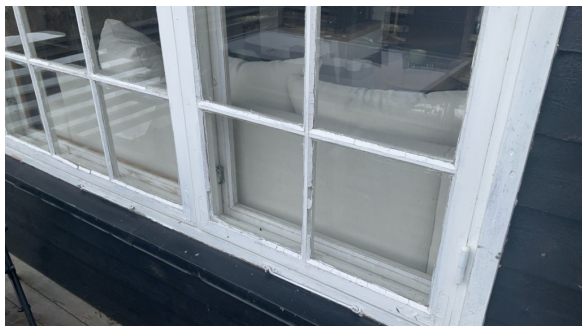
Behov for vedlikehold av vinduer.
