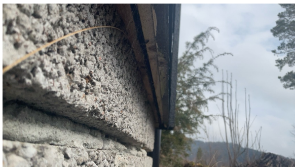
Kledning montert mot vindtetting uten lufting mellom.
