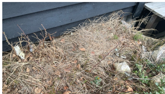
Kort avstand mellom terreng og kledning.
