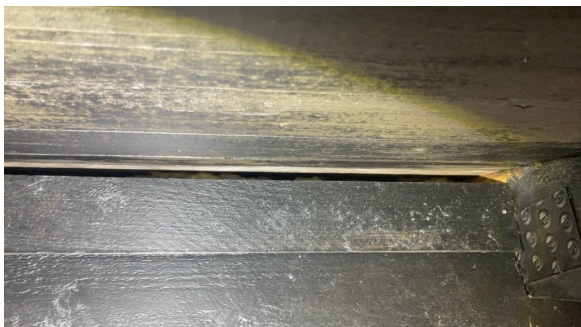
Begrenset lufting ned mot yttervegg.
