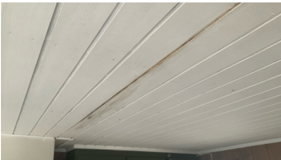
Fuktmerker i tak mellom stue og kjøkken.
