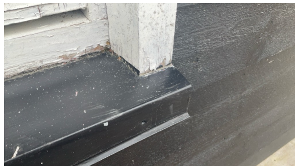
Manglende glipe ned mot vannbrett.
