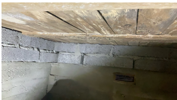
Misfarging på bordtak.
