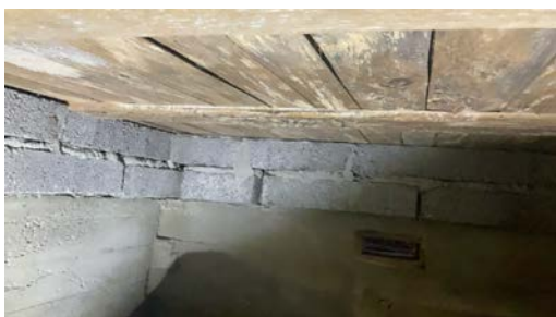
Misfarging på bordtak.
