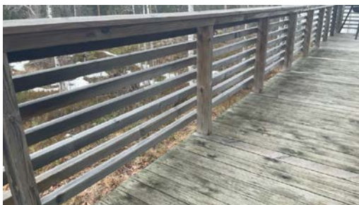
For stor åpning mellom horisontale spiler i rekkverk.
