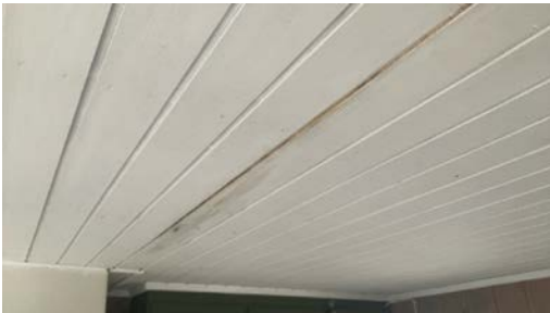
Fuktmerker i tak mellom stue og kjøkken.
