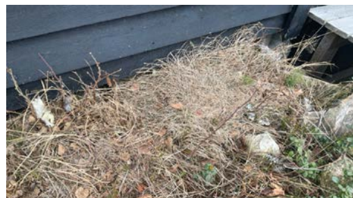
Kort avstand mellom terreng og kledning.
