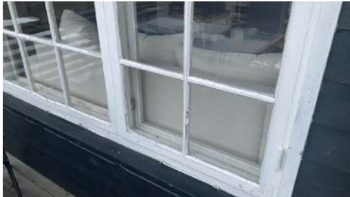
Behov for vedlikehold av vinduer.
