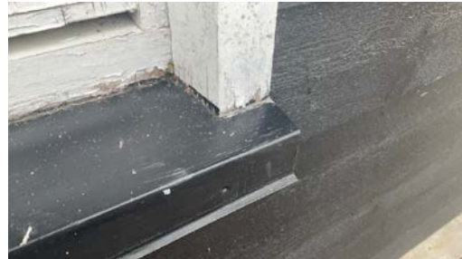
Manglende glippe ned mot vannbrett.
