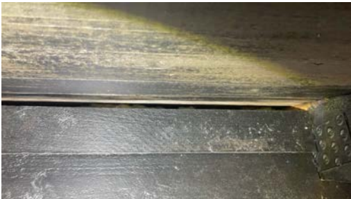
Begrenset lufting ned mot yttervegg.
