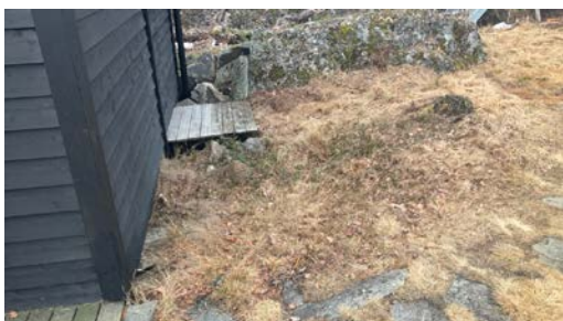
Lokalt fall mot grunnmur.
