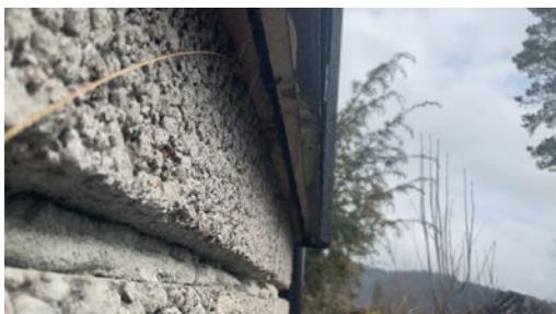
Kledning montert mot vindtetting uten lufting mellom.
