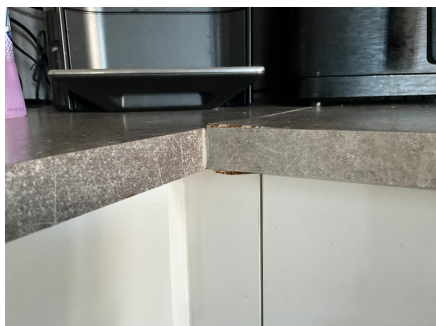
Fuktsvelling i benkeplaten.
