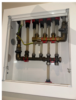
Samleskap med rørkurser og stoppekraner
