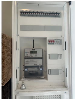
Sikringskap med automatsikringer.
