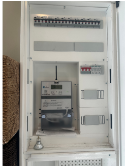
Sikringskap med automatsikringer.
