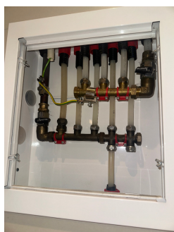
Samleskap med rørkurser og stoppekraner
