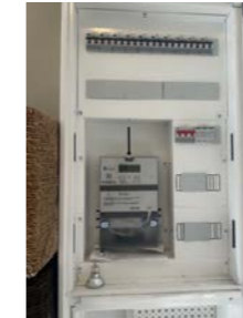
Sikringsskap med automatsikringer.
