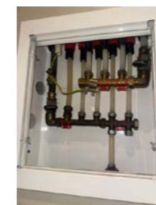
Samleskap med rørkurser og stoppekraner
