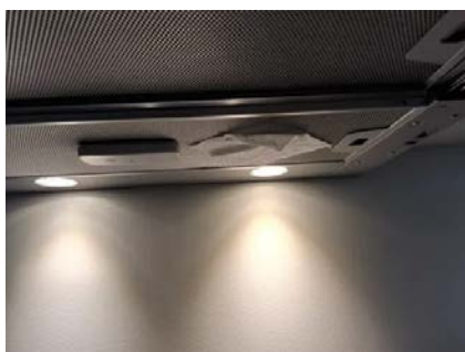
Avtrekkseffekten er testet med papir.
