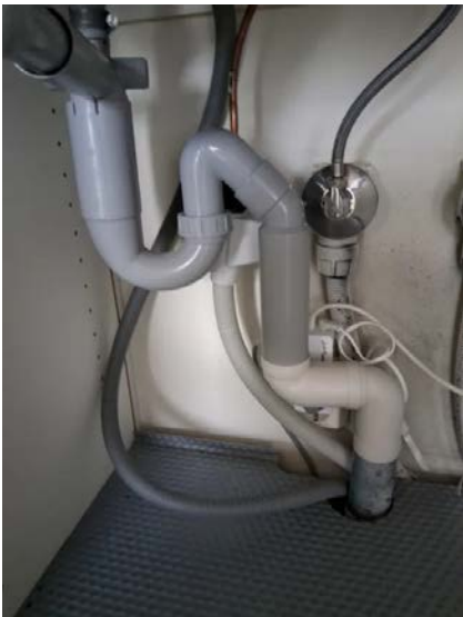
Leiligheten har synlige avløpsrør av plast.
