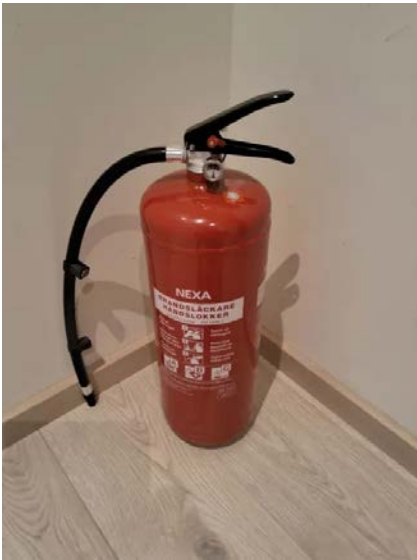
Brannslukningsapparat er plassert i entré.
