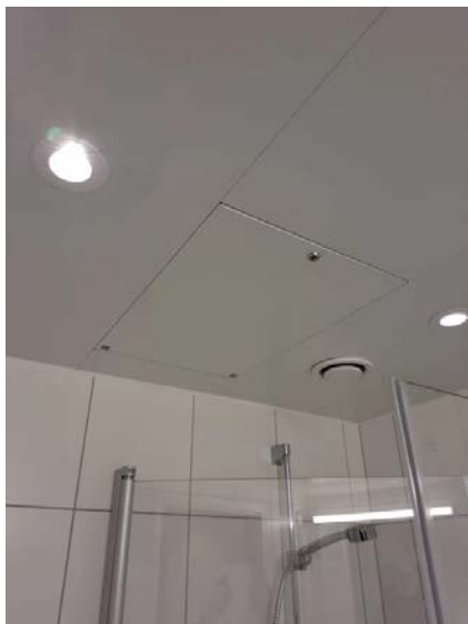
Fordelerskap på bad var låst befaringsdagen.
