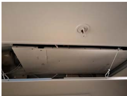
Ventilasjonsaggregat er plassert i himling i entré.
