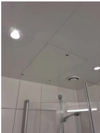
Fordelerskap på bad var låst befaringsdagen.
