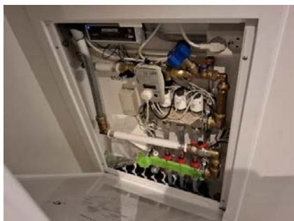
Fordelerskap for vannbåren gulvvarme er plassert i entré.
