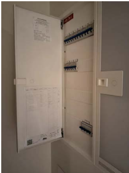
Sikringsskap er plassert i entré.
