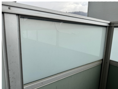
Sprekk i glass i øvre del av rekkverk.
