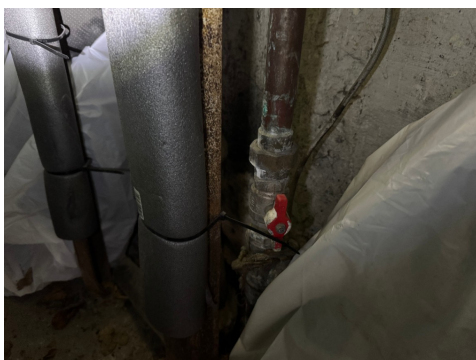
Felles hovedstoppekran i garasje i u-etg
