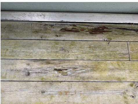
Lokal råte i terrassebord i ytre del av altan.
