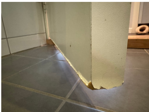
Fuktutsvelling/slitasje i nedre del av badedør.
