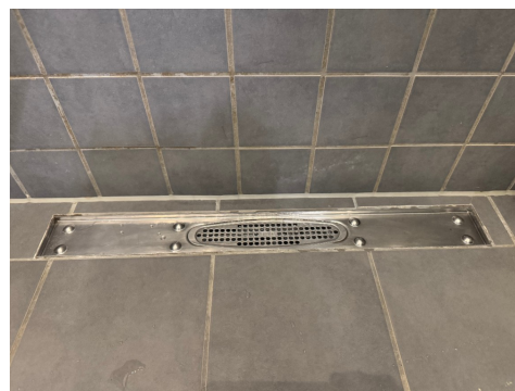
Avlang stålsluk i dusjsone.
