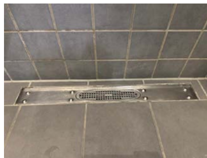
Avlang stålsluk i dusjsone.
