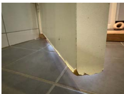
Fuktsvelling/slitasje i nedre del av badedør.
