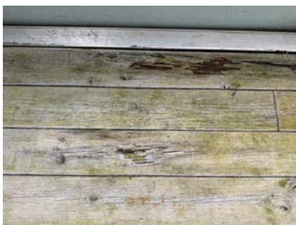
Lokal råte i terrassebord i ytre del av altan.
