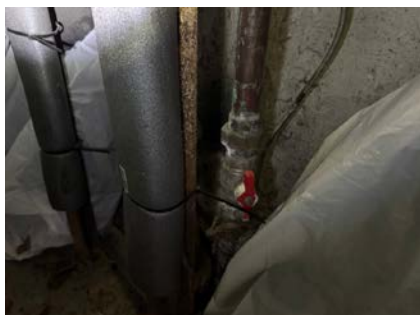
Felles hovedstoppekran i garasje i u-etg
