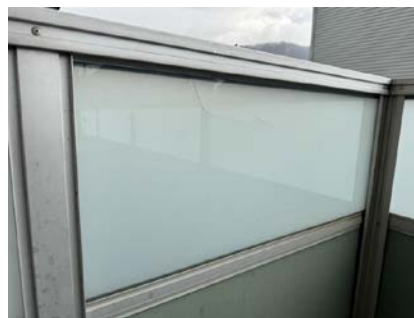
Sprekk i glass i øvre del av rekkverk.
