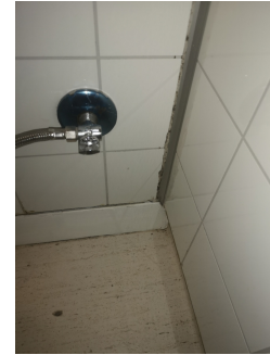
Usikker utførelse av hjørne samt et rart beslag ved gulv.
