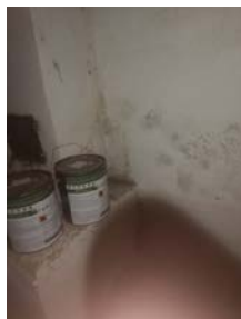
Fuktskjolder og saltutslag på betongflater.
