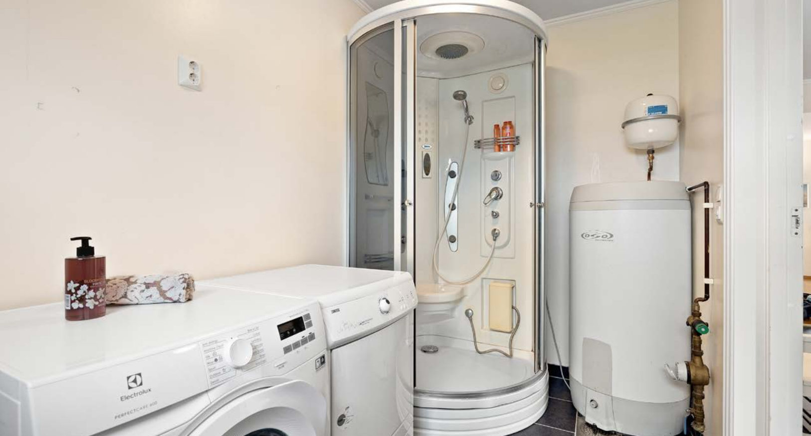
Rommet har dusjkabinett og opplegg for vaskemaskin.
