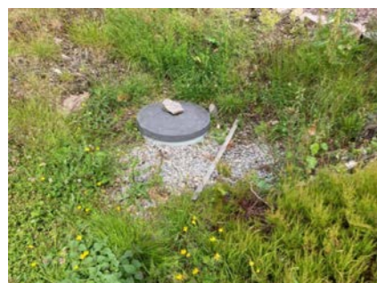
Tank for avløp.
