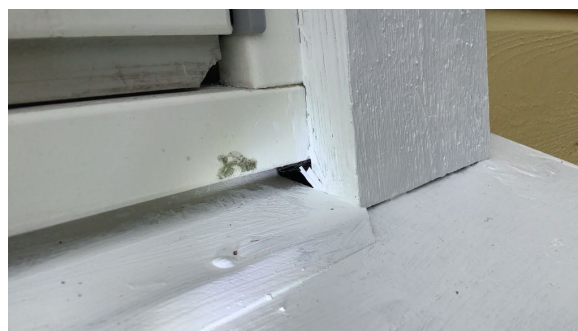
Mangler oppbrett på beslag
