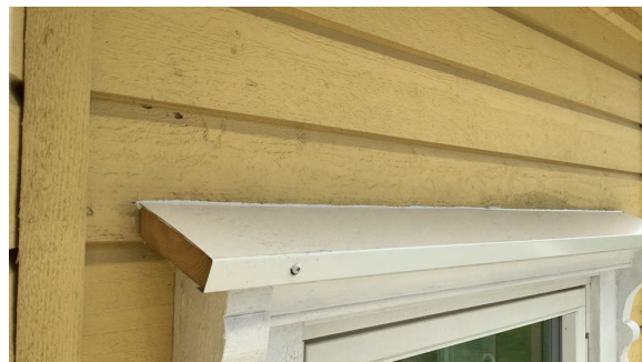
Beslag er ikke ført opp bak kledning
