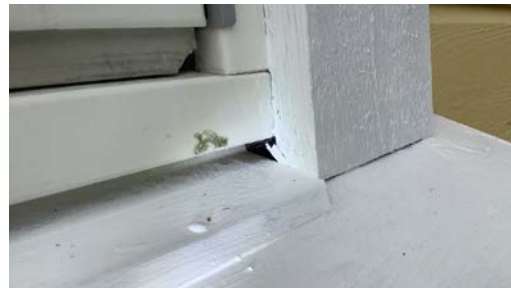
Mangler oppbrett på beslag
