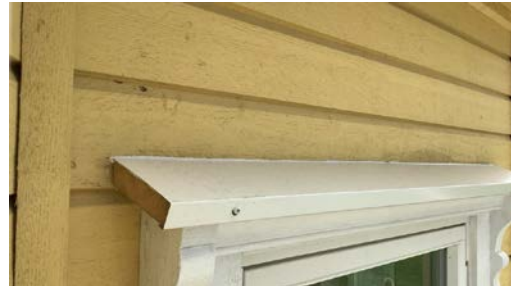
Beslag er ikke ført opp bak kledning
