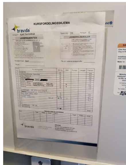
Elektrisk anlegg - [Kursfortegnelse ]
