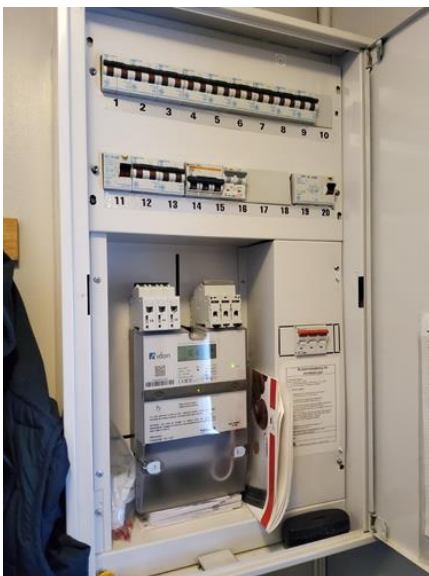
Elektrisk anlegg - [Sikringskap ]
