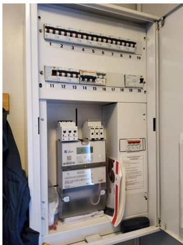
Elektrisk anlegg - [Sikringskap]
