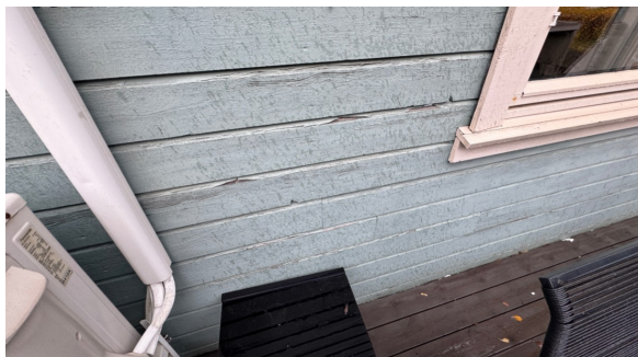
Bordkledningen er værslitt.
