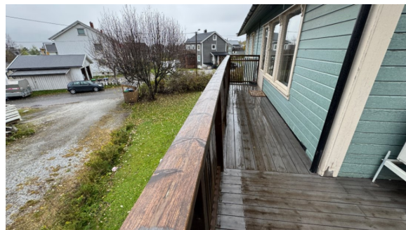
Det er registrert skjevheter i rekkverket.
