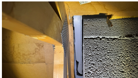
Gjennomføringer i undertaket er ikke utført med tilfredsstillende tetting.
