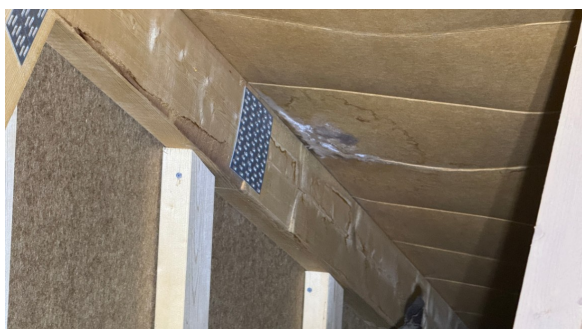
Fuktskjolder i undertak og takkonstruksjon.
