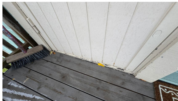
Døren har noe værslitasje.
