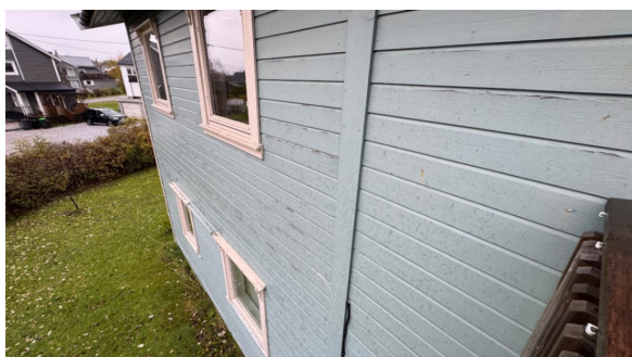
Bordkledningen er værslitt.
