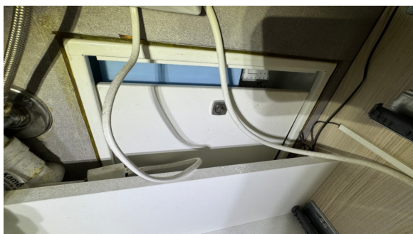
Rørfordelerskap plasser bak servanten på badet.
