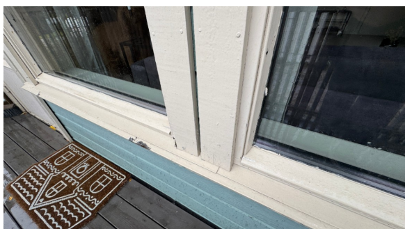
Vinduer er noe utvendig værslitt.
