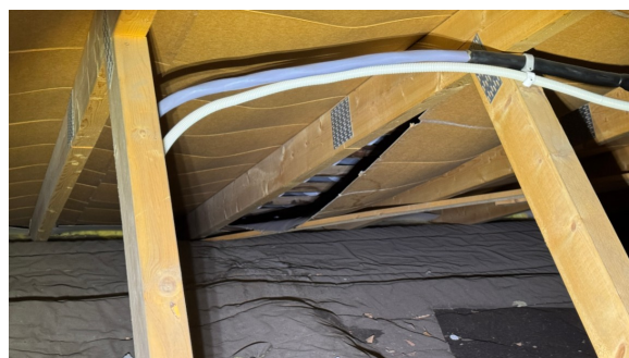
Deler av undertaket har løsnet.
