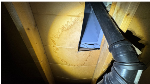
Gjennomføringer i undertaket er ikke utført med tilfredsstillende tetting.
