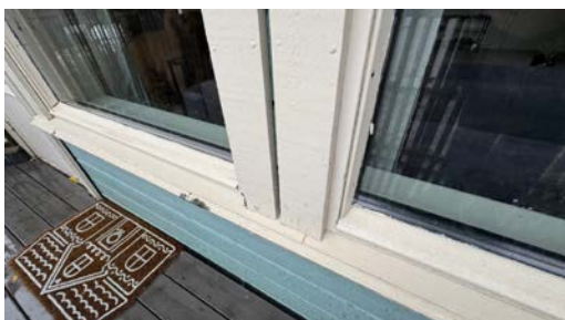
Vinduer er noe utvendig værslitt.
