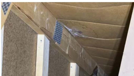
Fuktskjolder i undertak og takkonstruksjon.
