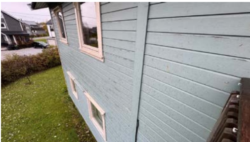
Bordkledningen er værslitt.
