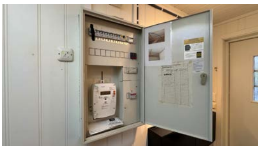
Kontroll av el-skap og kursfortegnelse.
