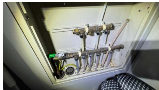
Kontroll av rørfordelerskap.
