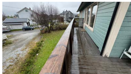
Det er registrert skjevheter i rekkverket.
