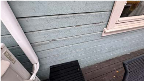
Bordkledningen er værslitt.
