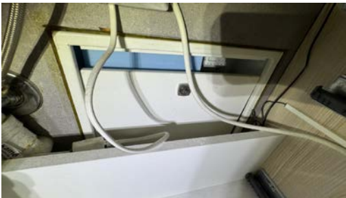
Rørfordelerskap plasser bak servanten på badet.
