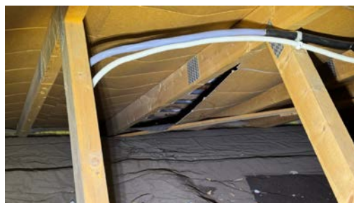
Deler av undertaket har løsnet.
