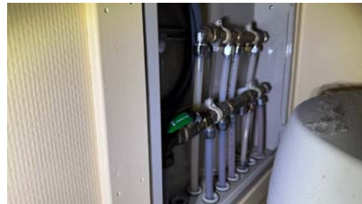
Kontroll av rørfordelerskap.
