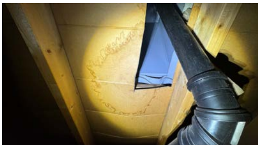
Gjenomføringer i undertaket er ikke utført med tilfredsstillende tetting.
