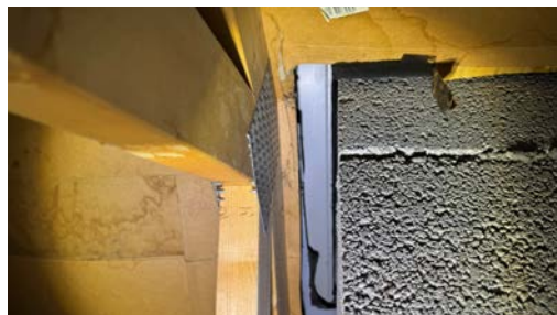
Gjenomføringer i undertaket er ikke utført med tilfredsstillende tetting.
