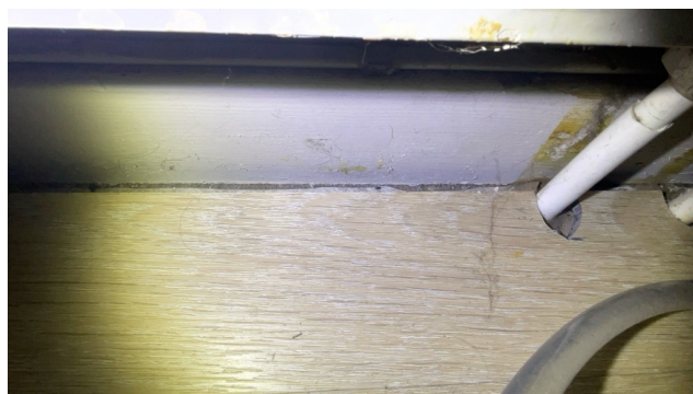
Tettesjikt/belegg under vinylplank stopper ved fotlist
