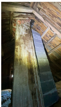
Litt skjolder ved pipeveksling og bek på pipe, men ikke målt unormal fukt
