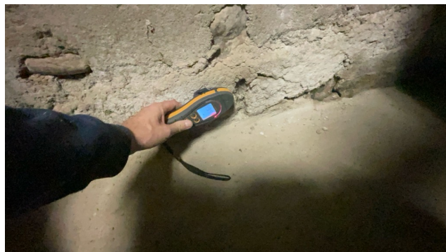
Fuktsøk kjellervegg med økning mot gulv
