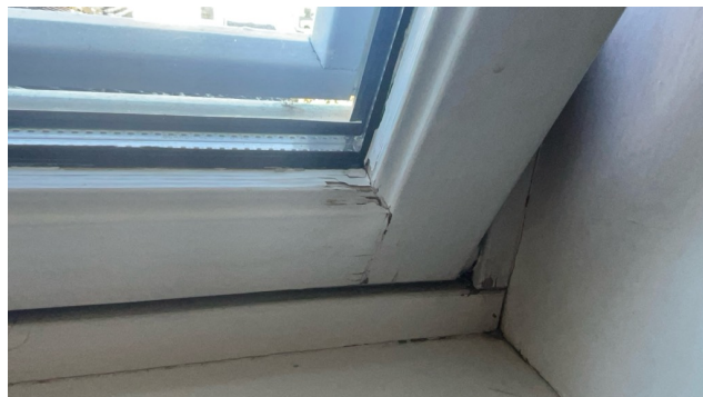
Symptom til litt kondensering i nedkant karm/hjørner
