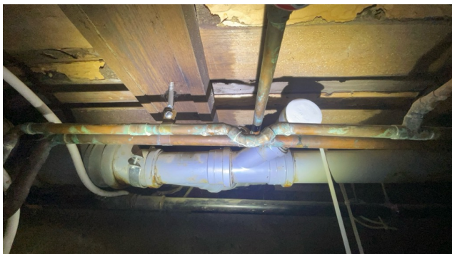
Eksempel kobber-rør i kjeller
