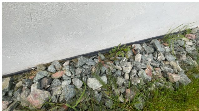
Toppliste fuktsperre gavl
