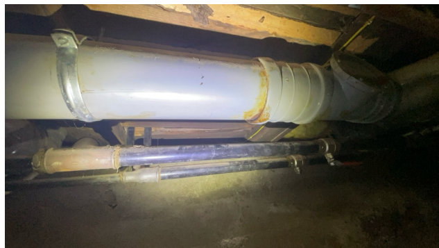
Symptom på noe "svetting" i rørmuffer
