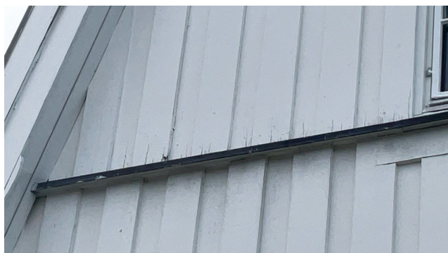
Sprekker i endeved (partiell råte kan finnes)
