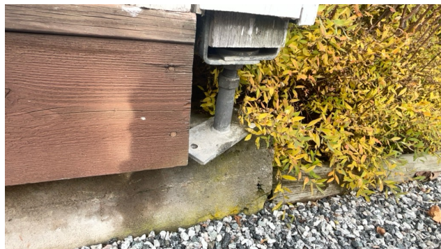
Søylesko glidd noe av for inngangsparti
