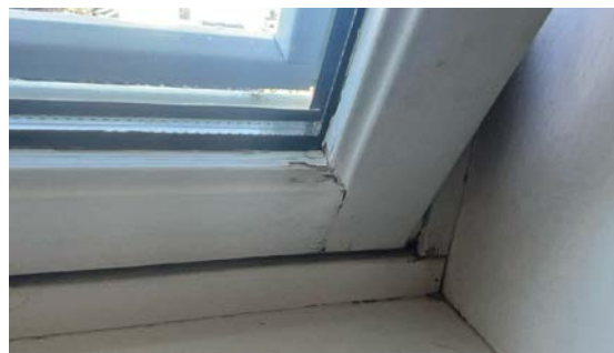
Symptom til litt kondensering i nedkant karm/hjørner
