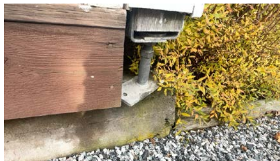
Søylesko glidd noe av for inngangsparti
