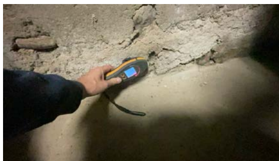
Fuktsøk kjellervegg med økning mot gulv
