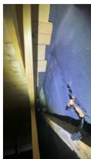
Ikke oppbrett på undertak/papp mot gammel del i tilbygg- litt skjolder på sortpapp vegg loft.
