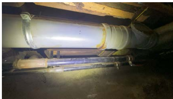
Symptom på noe "svetting" i rørmuffer
