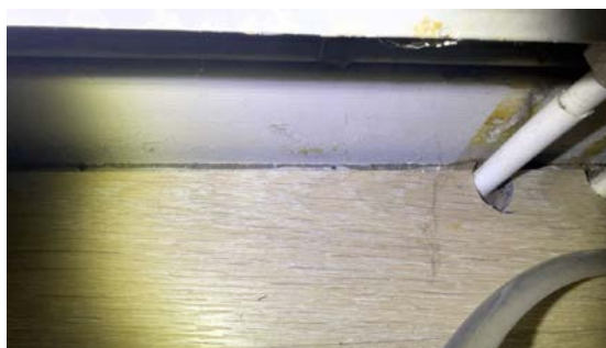
Tettesjikt/belegg under vinylplank stopper ved fotlist
