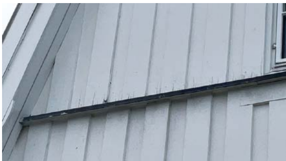
Sprekker i endeved (partiell råte kan finnes)
