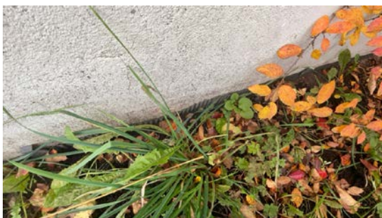
Fuktsperre uten toppliste nedside
