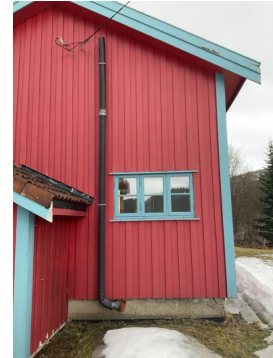
Utvendig lufting som ikke er tilkoblet.
