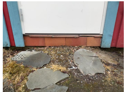
Manglende beslag under døra.
