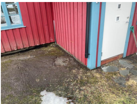
Ingen overløpsrør for bortledning av takvann.
