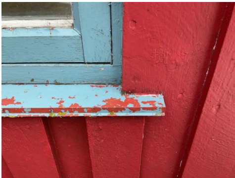
Ingen etablert dryppnese rundt vinduer.
