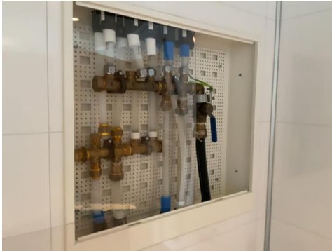
Rørskap på bad.
