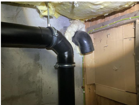
Innvendig lufting av avløp er ikke tilkoblet.
