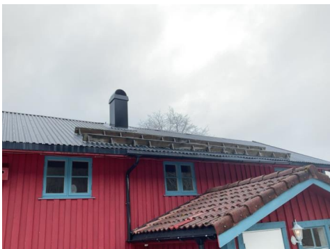
Manglende takrenner på hovedtak.
