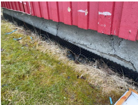
Sprekker i grunnmur.
