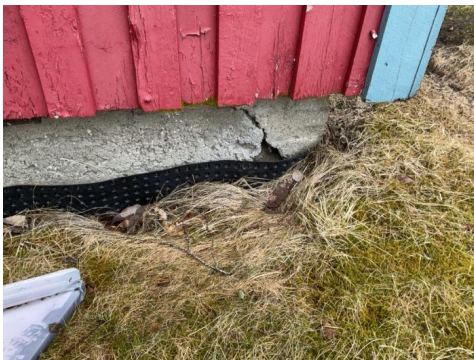
Sprekk i grunnmur.
