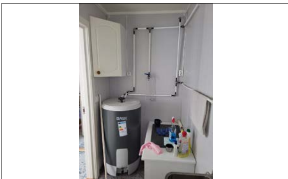
Fjøs, bereder plassert i 2. etasje.
