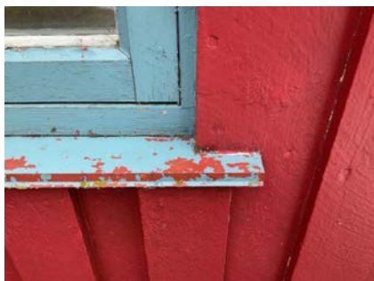
Ingen etablert dryppnese rundt vinduer.
