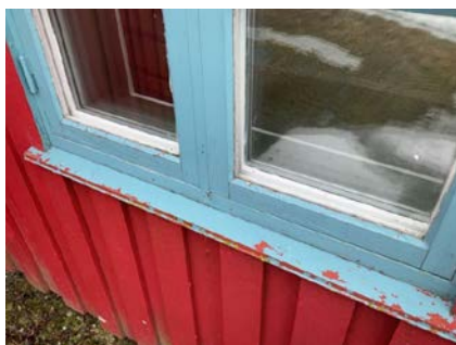
Eldre karmner på vinduer.
