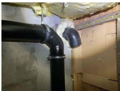
Innvendig lufting av avløp er ikke tilkoblet.
