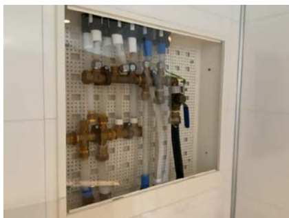
Rørskap på bad.
