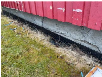
Sprekker i grunnmur.
