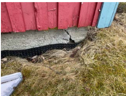
Sprekk i grunnmur.
