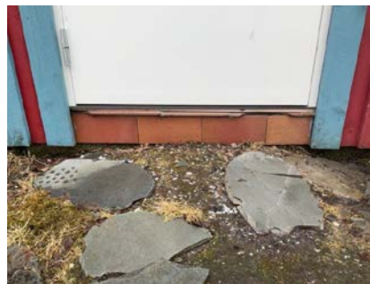
Manglende beslag under døra.
