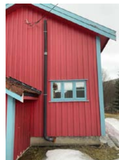
Utvendig lufting som ikke er tilkoblet.
