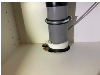
Ufagmessig utførelse av hull for ventilasjonsrør.
