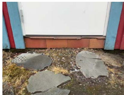
Manglende beslag under døra.
