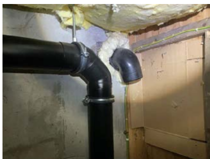
Innvendig lufting av avløp er ikke tilkoblet.
