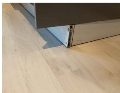
Manglende arbeid på sokkel under innredning.
