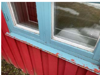
Eldre karmner på vinduer.
