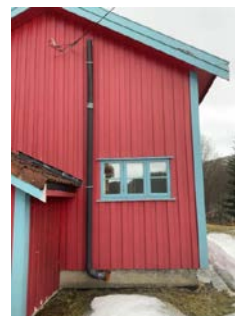
Utvendig lufting som ikke er tilkoblet.
