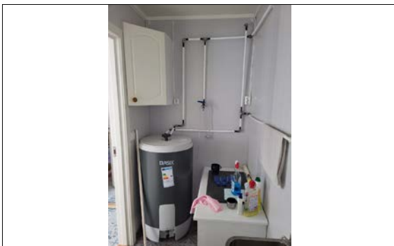
Fjøs, bereder plassert i 2. etasje.
