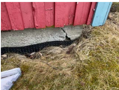
Sprekk i grunnmur.
