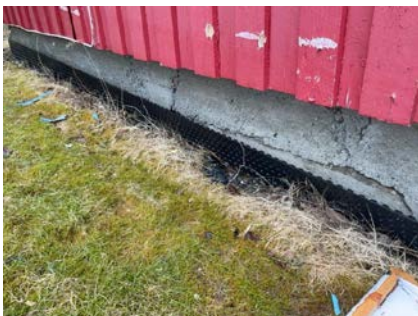
Sprekker i grunnmur.
