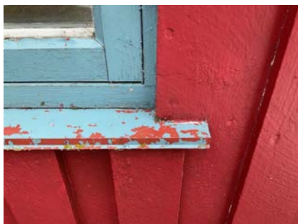
Ingen etablert dryppnese rundt vinduer.
