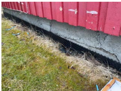
Sprekker i grunnmur.
