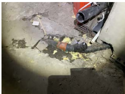
Avløpsrør i kjeller.
