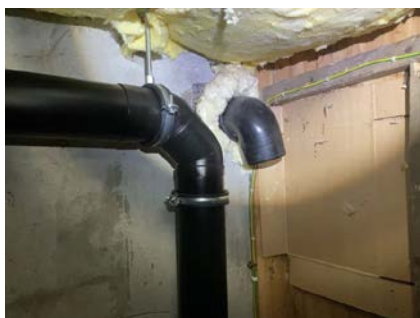
Innvendig lufting av avløp er ikke tilkoblet.
