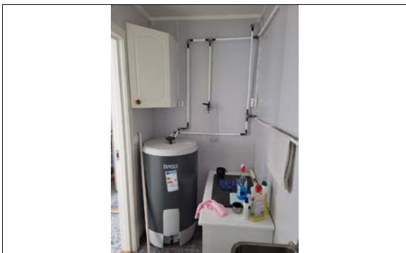
Fjøs, bereder plassert i 2. etasje.
