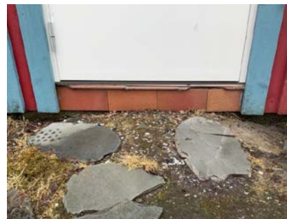
Manglende beslag under døra.
