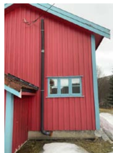
Utvendig lufting som ikke er tilkoblet.
