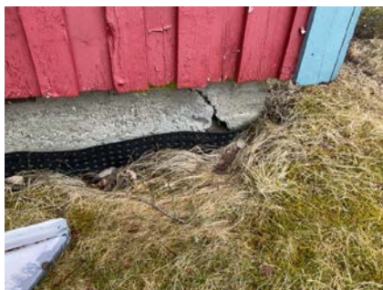
Sprekk i grunnmur.
